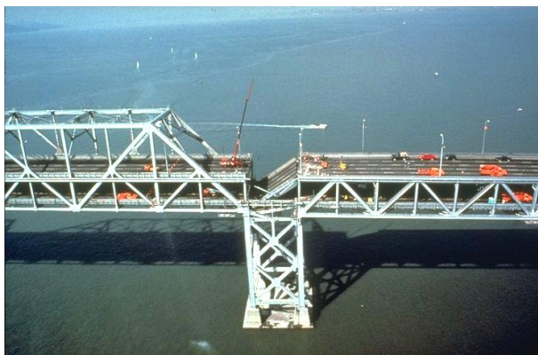
Σχήμα 1: Απώλεια στατικής ισορροπίας καταστώματος (Loma Prieta, 1994) Figure 1: Deck unseating (Loma Prieta, 1994)
