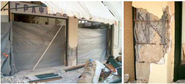
Σχήμα 6. Καμπτική αστοχία των υποστυλωμάτων της εισόδου του καταστήματος. Figure 6. Flexural failure of the columns at the store entrance.
