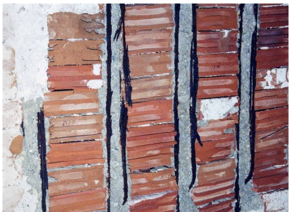
Εικ. 32 Πλήρης οξείδωση των κύριων οπλισμών της πλάκας οροφής ορόφου της πτέρυγας Α
