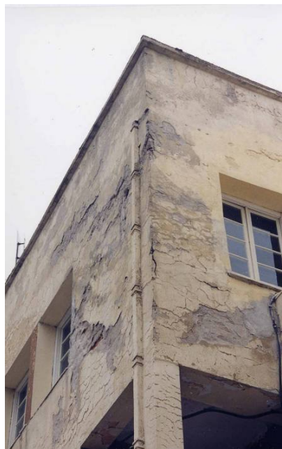
Εικ. 3 Αποκόλληση επιχρισμάτων λόγω επιφανειακών ομβρίων στην πτέρυγα Β
