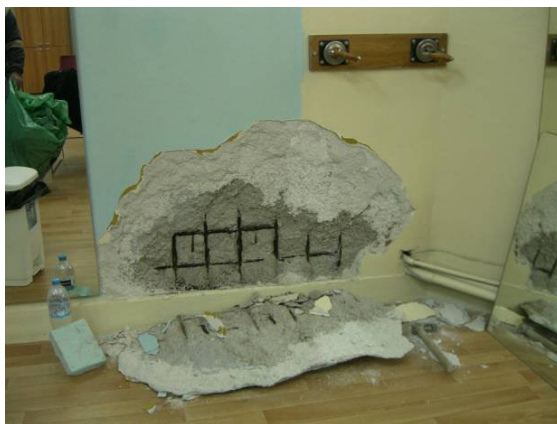
Εικ. 33 Έντονη οξείδωση σε τοίχο ισογείου της πτέρυγας Α
