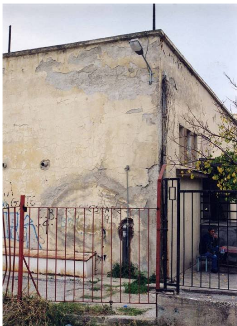
Εικ. 30 Αποσάθρωση επιχρίσματος από διαρροές υδρορροής στην πτέρυγα Α
