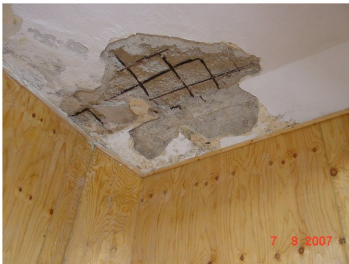
Εικ. 34 Αποφλοίωση σκυροδέματος και οξείδωση οπλισμών στην πλάκα οροφής ισογείου της πτέρυγας Α, οφειλόμενη σε διαρροή των υπερκειμένων χώρων υγιεινής
